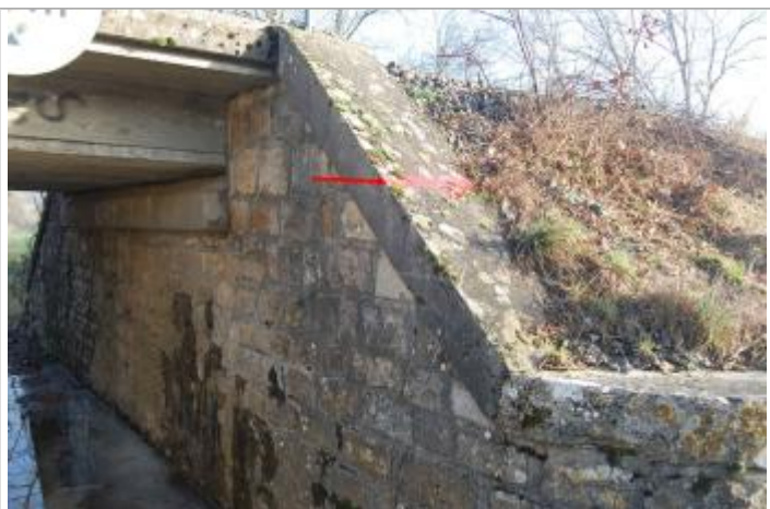
Vue de la laisse d'inondation - Auteur : GEOSPHAIR
