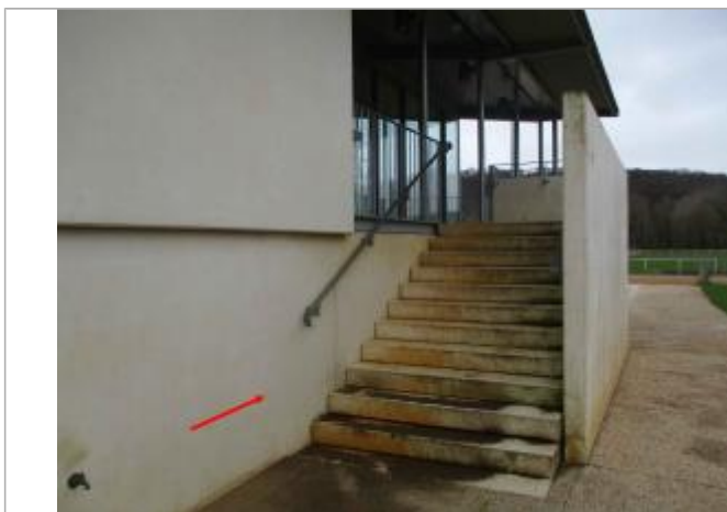
Vue de la laisse d'inondation - Auteur : DDT46
