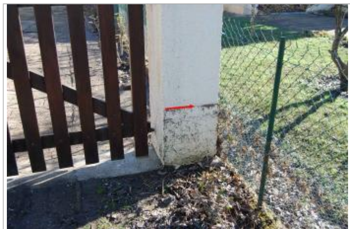
Vue de la laisse d'inondation - Auteur : GEOSPHAIR
