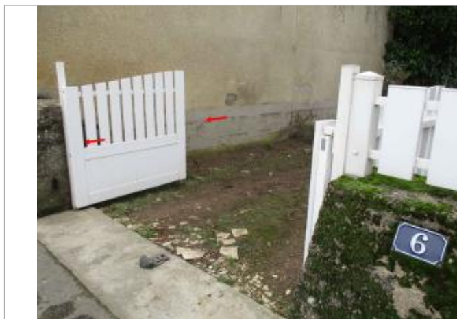
Vue de la laisse d'inondation - Auteur : DDT46
