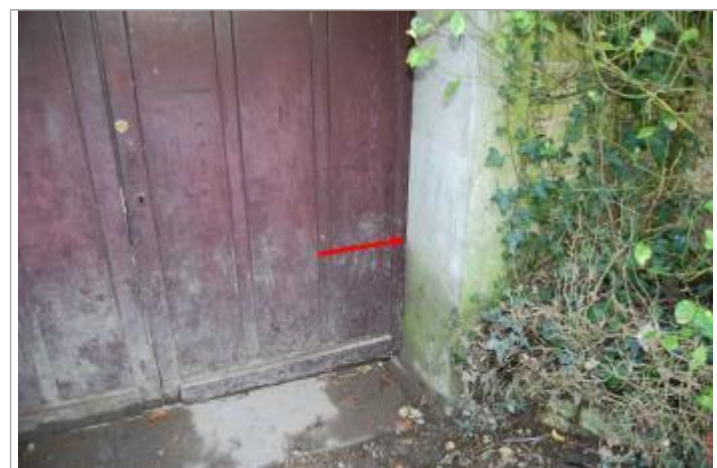
Vue de la laisse d'inondation - Auteur : GEOSPHAIR
