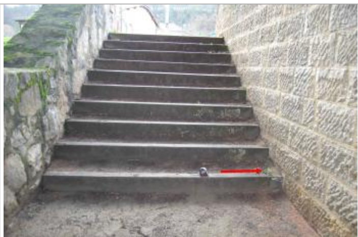
Vue de la laisse d'inondation - Auteur : GEOSPHAIR
