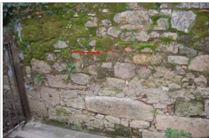
Vue de la laisse d'inondation - Auteur : GEOSPHAIR
