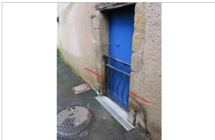
Vue de la laisse d'inondation - Auteur : DDT46
