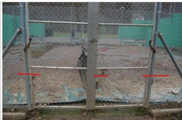
Vue de la laisse d'inondation - Auteur : GEOSPHAIR
