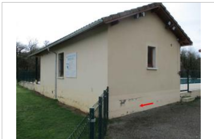
Vue de la laisse d'inondation - Auteur : DDT46
