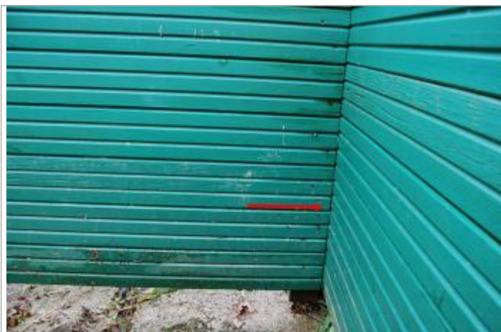
Vue de la laisse d'inondation - Auteur : GEOSPHAIR
