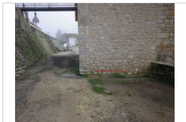
Vue de la laisse d'inondation - Auteur : GEOSPHAIR
