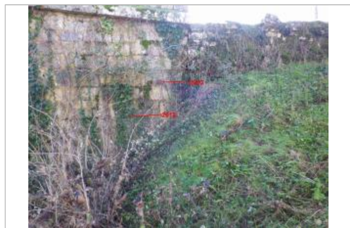
Vue de la laisse d'inondation - Auteur : GEOSPHAIR
