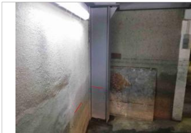
Vue de la laisse d'inondation - Auteur : GEOSPHAIR
