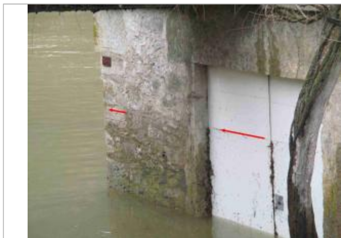
Vue de la laisse d'inondation - Auteur : DDT46
