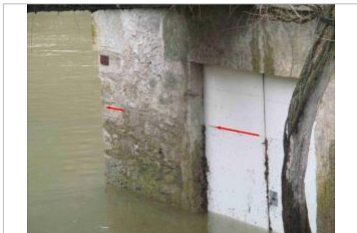
Vue de la laisse d'inondation - Auteur : DDT46
