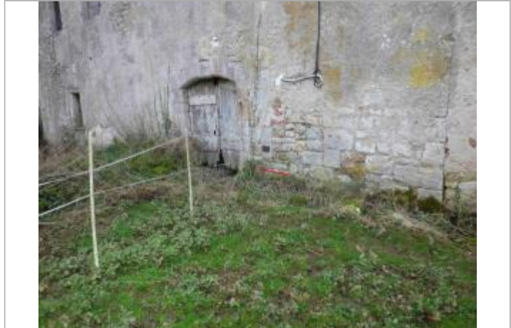
Vue de la laisse d'inondation - Auteur : GEOSPHAIR
