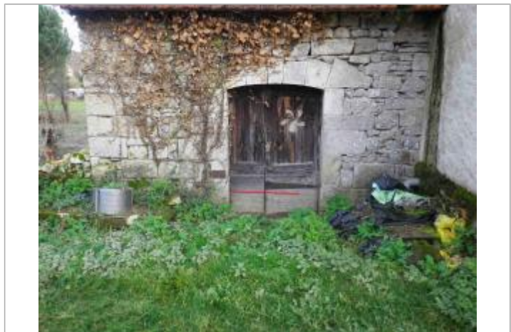
Vue de la laisse d'inondation - Auteur : GEOSPHAIR
