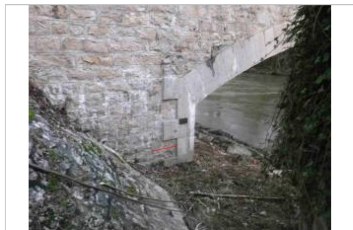
Vue de la laisse d'inondation - Auteur : GEOSPHAIR
