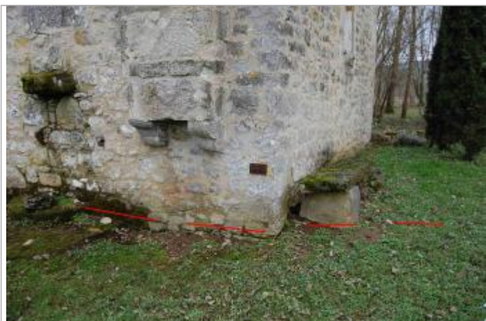
Vue de la laisse d'inondation - Auteur : GEOSPHAIR
