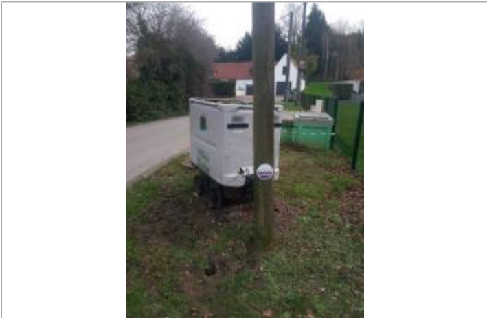
site du repère
