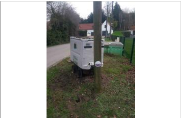
site du repère
