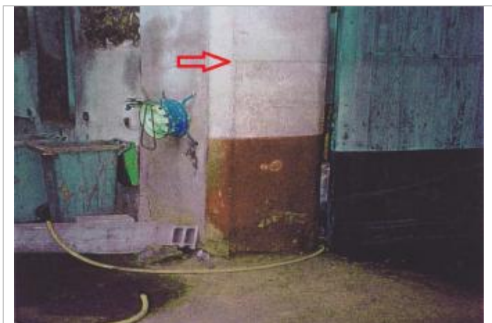
Pilier de garage
