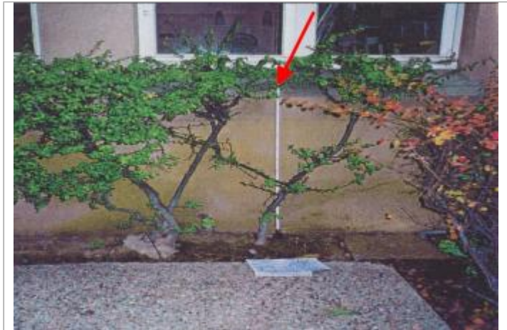
Laisse sur façade derrière la haie
