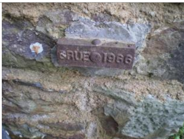
Repère de crue d'octobre 1966 sur bâtiment agricole
