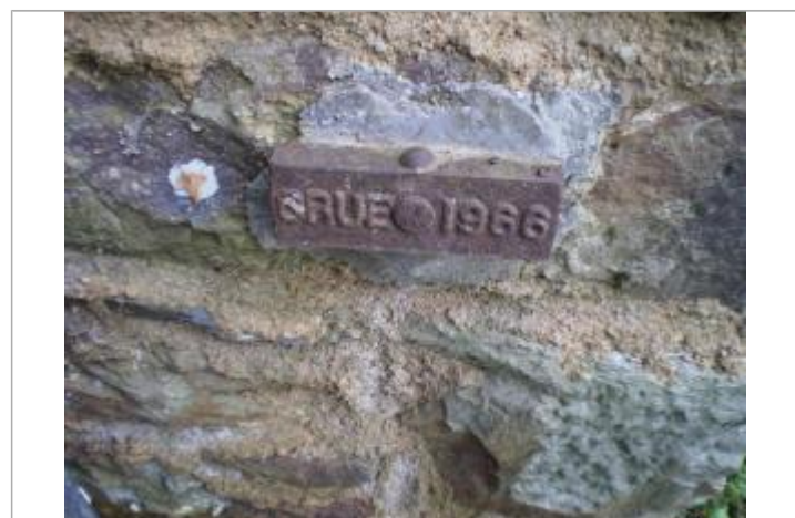
Repère de crue d'octobre 1966 sur bâtiment agricole
