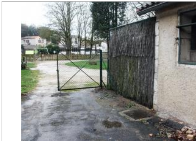
Façade intérieure du local technique - jardin public de Chauvigny
