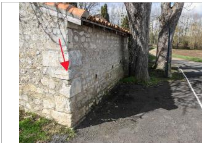
Photographie repère crue 1896 - façade mur église
