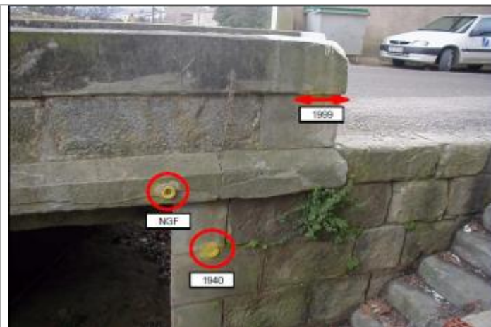
Pont de la RD 111 - Peinture sur parapet amont
