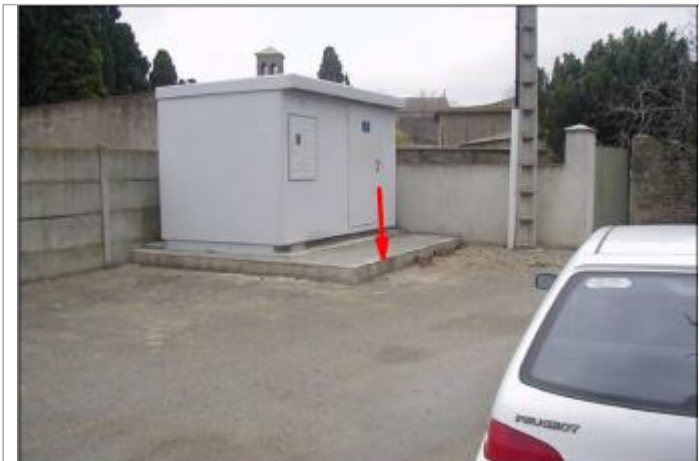
Socle du transformateur
