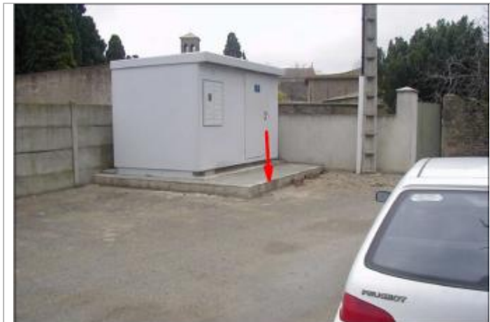
Socle du transformateur
