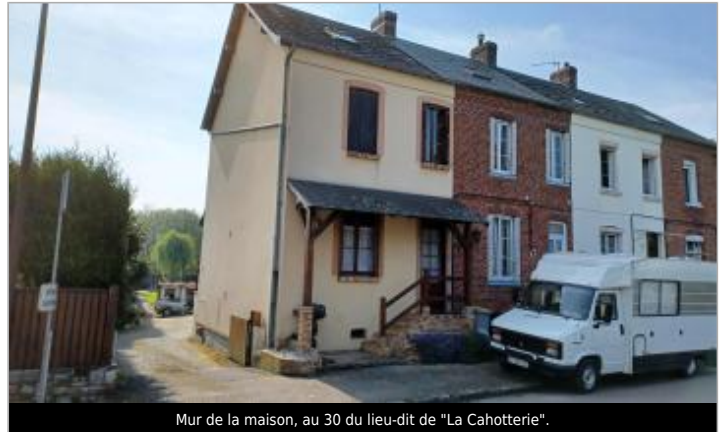
Mur de la maison, au 30 du lieu-dit de "La Cahotterie".
