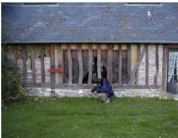
Au niveau de l'habitation, l'eau est montée à environ 30 cm sous le haut de la poutre (Source : SAFEGE)
