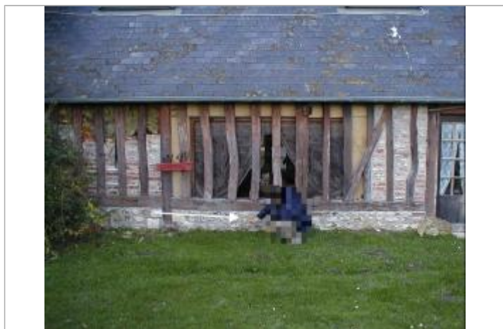
Au niveau de l'habitation, l'eau est montée à environ 30 cm sous le haut de la poutre (Source : SAFEGE)
