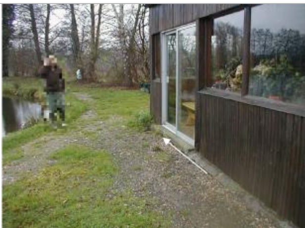
L'eau est arrivée jusqu'au niveau du seuil de la porte d'entrée du cabanon situé devant le lac de pêche à la truite (Source : SAFEGE)
