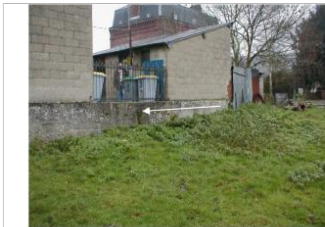
L'eau est montée jusqu'à 15 cm en-dessous du sommet du muret (source : SAFEGE)
