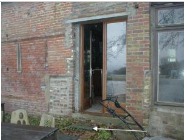
L'eau est arrivée au ras de la grille située devant la porte donnant du côté de la rivière (source : SAFEGE)
