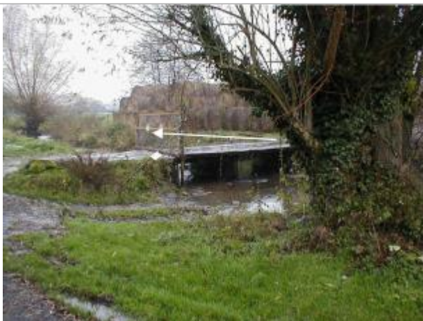
Au plus fort de la crue, la hauteur d'eau était de 30 cm sur le pont (source : SAFEGE)
