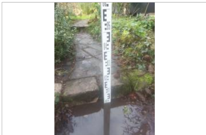
1ère marche avant terrasse - 2cm d'eau - vue rapprochée (source SMBVR)
