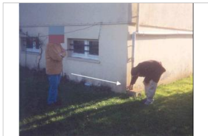
La trace de l'inondation était encore visible sur un des murs de la maison (Source : SAFEGE)
