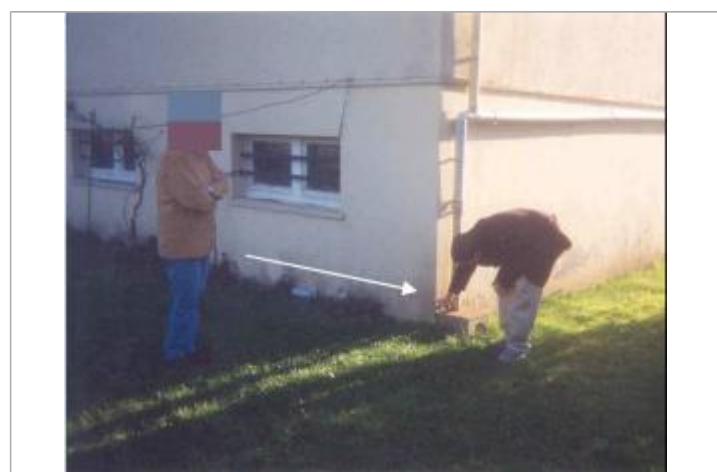
La trace de l'inondation était encore visible sur un des murs de la maison (Source : SAFEGE)
