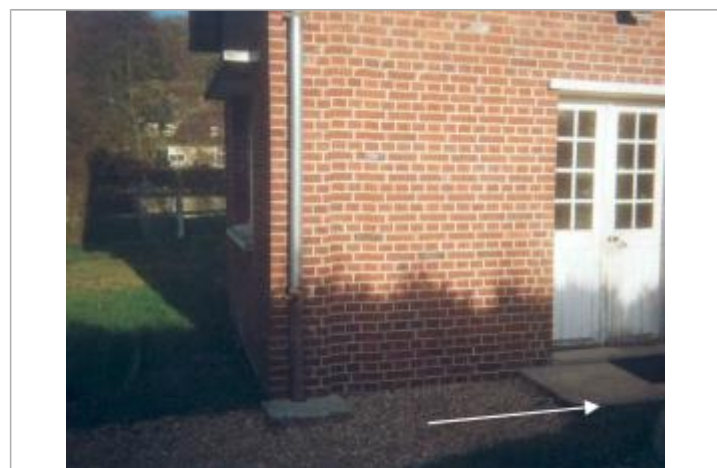
L'eau est montée jusqu'à la marche d'entrée (Source : SAFEGE)
