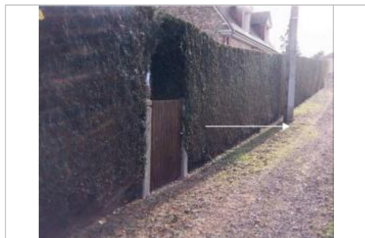
L'eau est arrivée pratiquement jusqu'au pied du poteau EDF (Source : SAFEGE)
