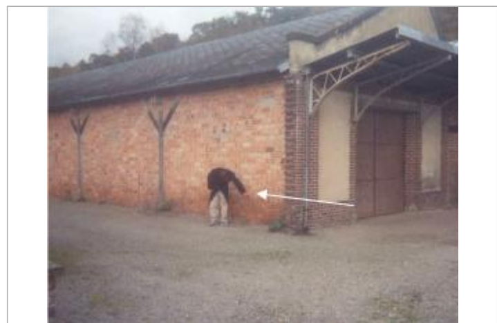
Les plus hautes eaux ont atteint la base de la sixième brique en partant du sol du mur du hangar (Source: SAFEGE)
