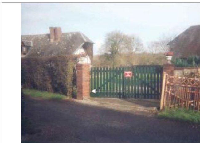
Eau montée jusqu'en haut de la quatrième brique du pilier du portail d'entrée (Source: SAFEGE)
