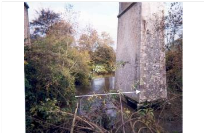
Niveau d'eau monté en haut de la troisième pierre sur le pilier central (Source: SAFEGE)
