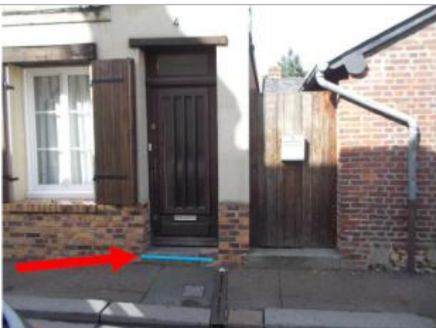
1 cm en dessous du seuil de la porte d'entrée (Source: EGIS)
