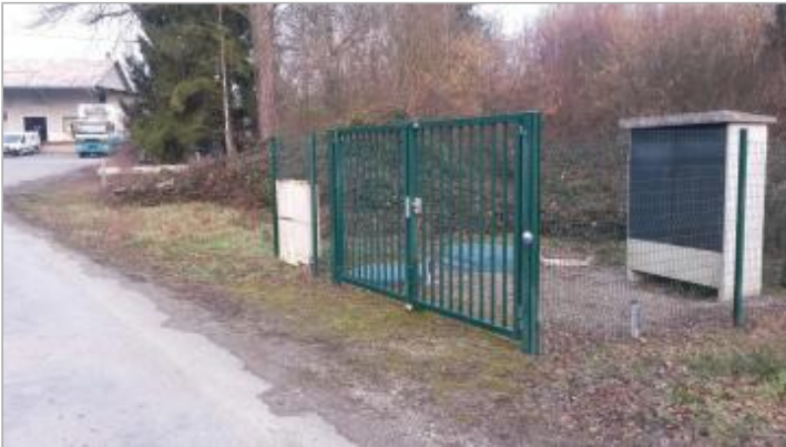
Transformateur électrique, Route de l'étang
