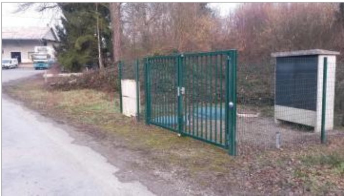
Transformateur électrique, Route de l'étang
