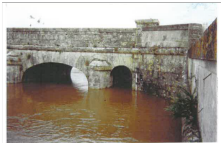
Site et repère pendant la crue (photo recensement d'origine)
