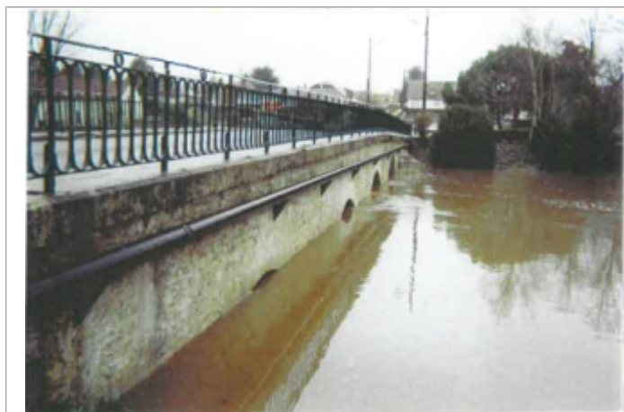
Site et repère pendant la crue (photo recensement d'origine)
