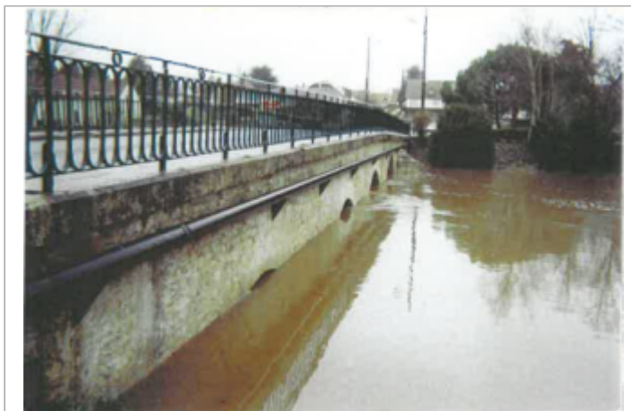
Site pendant la crue de 2001 (photo recensement d'origine)
